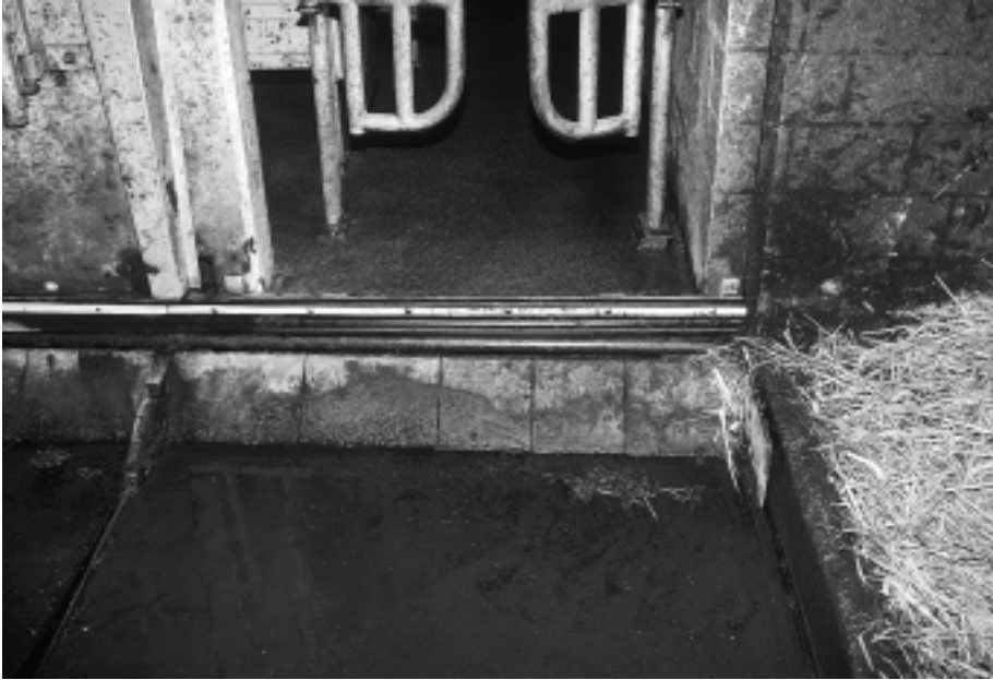
Fig. 16: Pour éviter les problèmes de gel, le racleur devrait être stationné dans une zone protégée.
