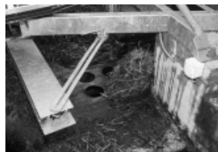
Fig. 13: En ce qui concerne les évacuateurs va-et-vient, les trous d'un diamètre de 15 cm environ constituent un système qui a fait ses preuves pour séparer la phase liquide du fumier contenant de la paille longue.
