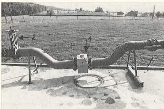
Abb. 2: Die Messeinrichtung für die Messung der Fördermenge mit dem Durchflusszähler (1) und dem Schieber (2) zur kontinuierlichen Verkleinerung der Fördermenge und Erhöhung des Förderdruckes.
