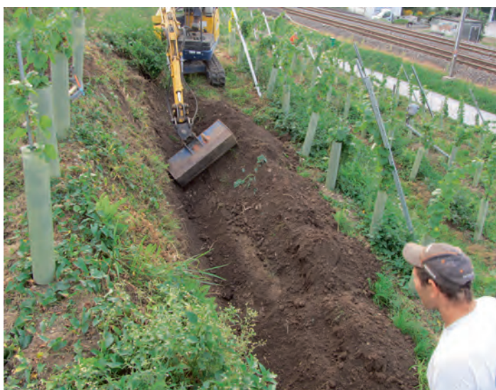
Abb. 9: Graben am Böschungsfuss.
