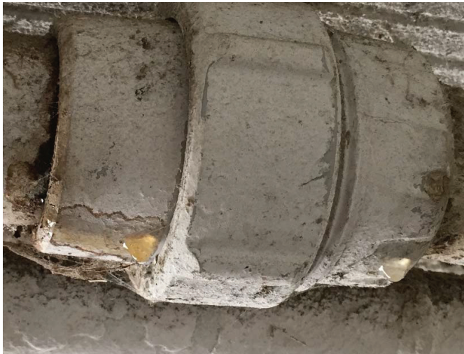
Abbildung 6: Undichte Verschraubung einer Milchleitung.
