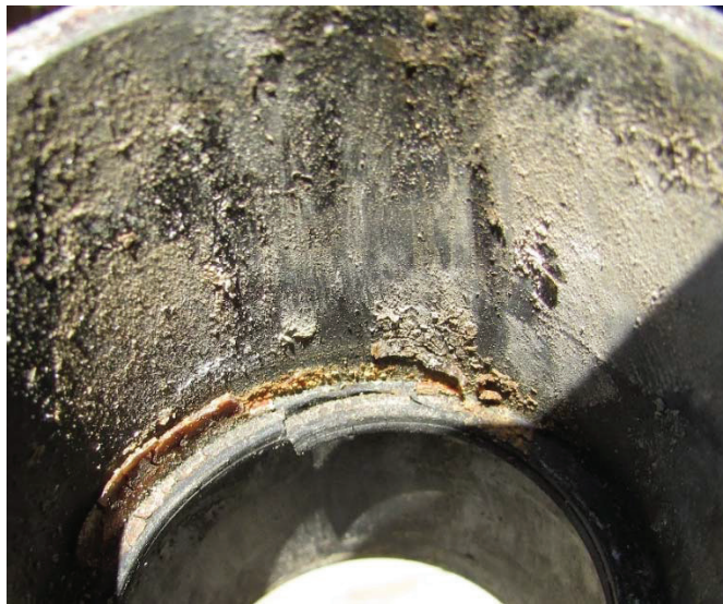
Abbildung 7: Defekte Dichtung aus Milchleitung mit Ablagerungen.
