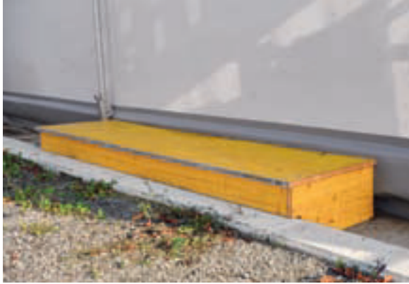
Mit einer einfachen Abdeckung beim Schieberbahnhof funktioniert die Entmistung bei kalten Temperaturen länger.
