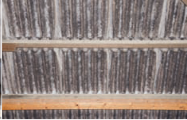
Nicht abgeführte Feuchtigkeit kondensiert an kälteren Bauteilen und es kann zu Schimmelbildung kommen.
