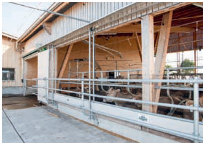
Mit Curtains oder Hubfenstern können die Fassadenöffnungen an die jeweilige klimatische Situation angepasst werden.
