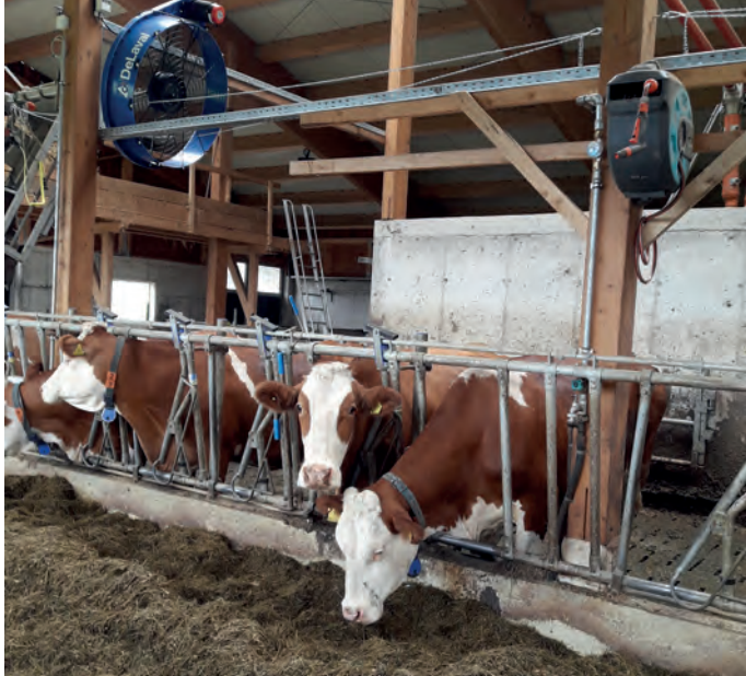
Je Einheit sind ein Ventilator und sechs wasserführende Düsen installiert, die etwa 15 Fressplätze erreichen.
