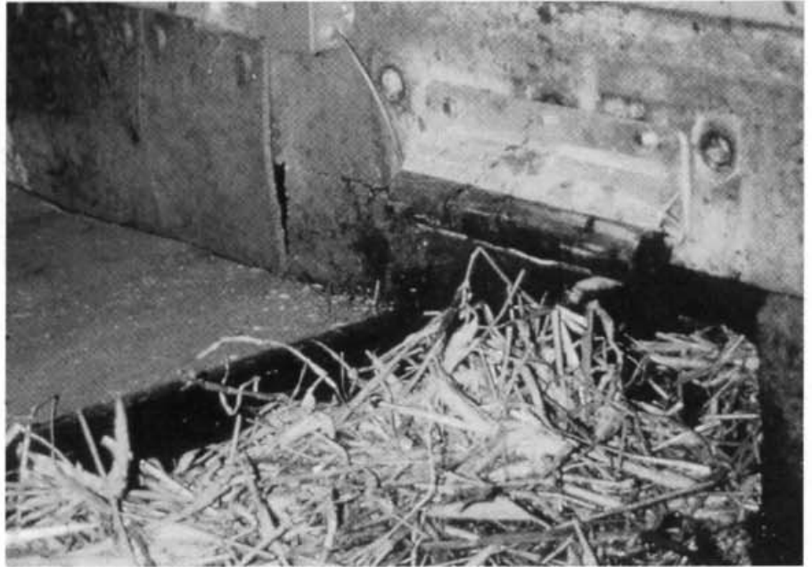
Abb. 8. Können bei Entmistungsanlagen die Sicherheitsabstände nicht eingehalten werden, so sind an Gefahrenstellen Kontaktelektroden einzubauen.
