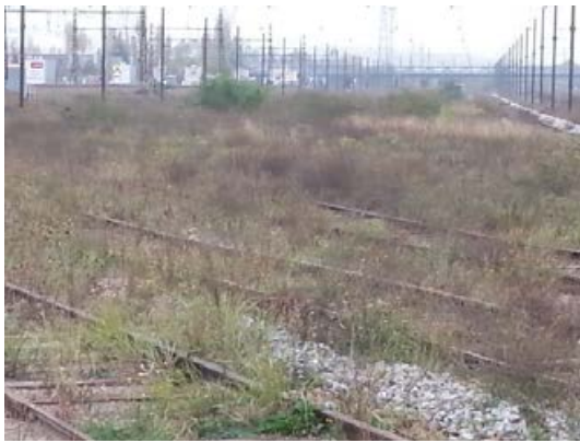
Massiver Bewuchs und Verbuschung des Geländes
