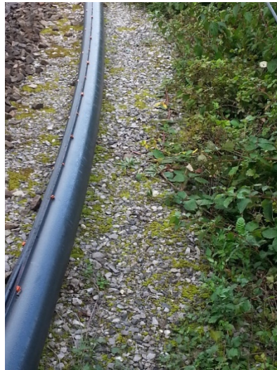
Zürich Affoltern, Griebuck – Rietbuck; Kabelkanal liegt (evtl wegen Bauarbeiten) auf einem bemoosten Bankett.
