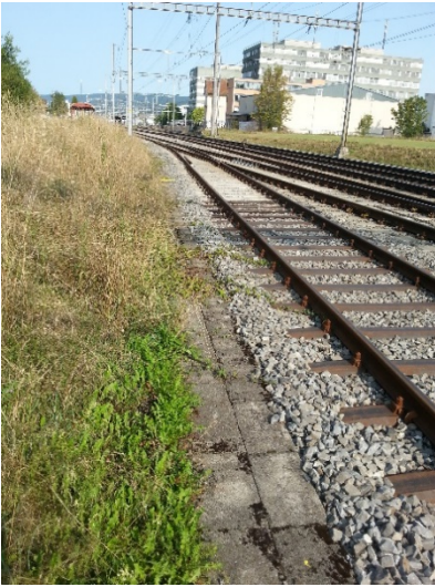
Regensdorf, Böschstrasse; anstelle eines Banketts wird der Kabelkanal doppelt geführt. Die Böschungsvegetation kriecht auf die Gleise.
