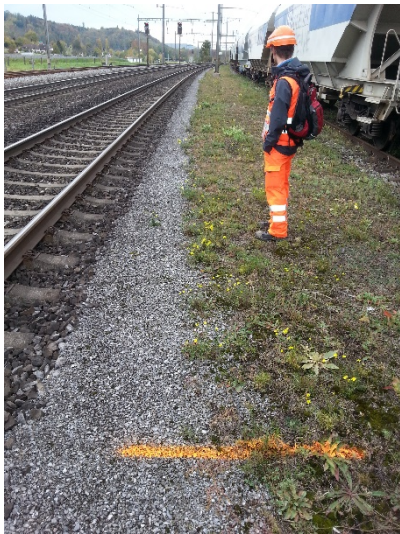
Bahnhof Rheinfelden: Mit Herbizid behandelter Streifen entlang der Gleisschotter.
