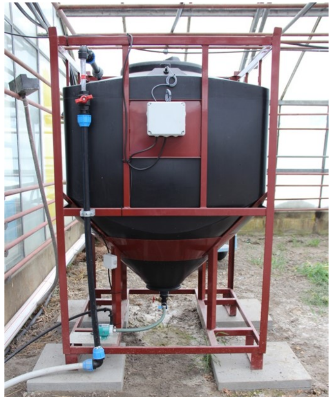
Abbildung 6: Sandfilter für die langsame Filtration. (Foto: V. Günther)
