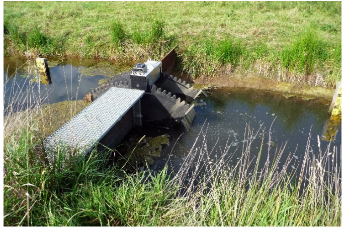
Abbildung 7: Klappenstau zur Wiedervernässung. So lässt sich die Stauhöhe in den Wassergräben zentimetergenau regulieren. Foto: Uwe Fuellhaas / DBU Naturerbe GmbH
