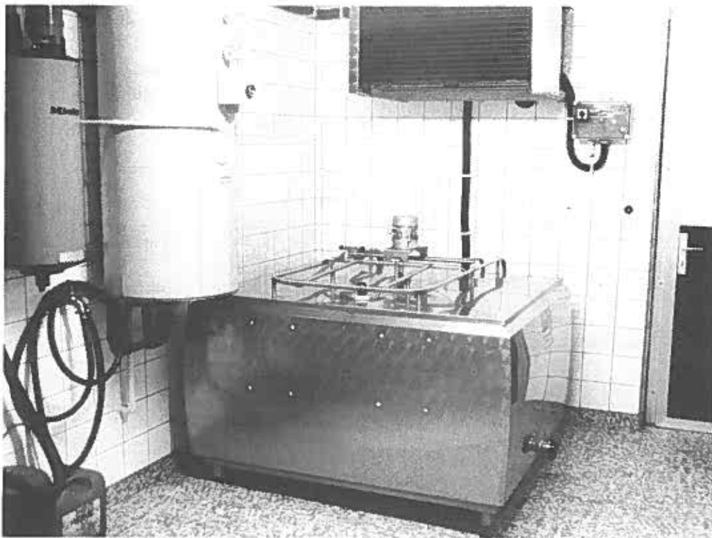
Abb. 15: Stationäre Kühlwanne mit Wärmerückgewinnung
