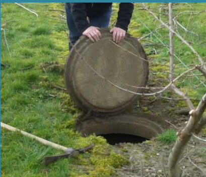
Geschlossene Deckel von Kontrollschächten
