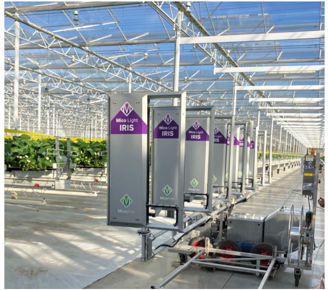
Robot UV-C permettant de traiter six rangées en un seul passage dans une serre.
