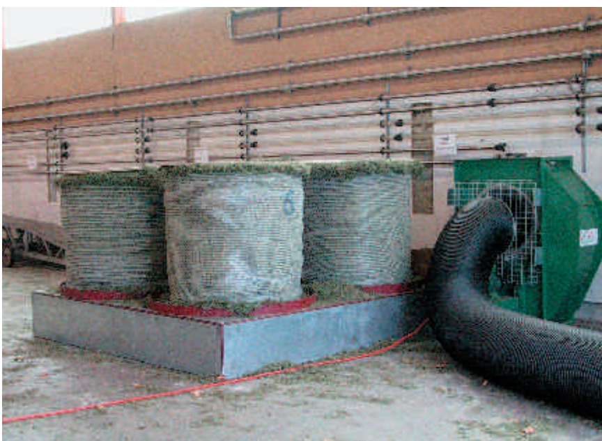
Fig. 3: L'installation de séchage GEBA pour balles rondes a demandé moins d'investissement, mais consomme beaucoup d'énergie.
