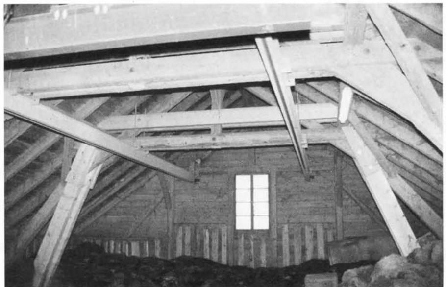
Fig. 7. Grue à griffe sur tourelle installée dans une grange existante. Outre un entrain moisé supplémentaire, les charpentes ont été renforcées jusqu'au sol au moyen de contre-fiches. Si celles-ci entrent dans le tas de foin ventilé, elles doivent être entourées d'une cloison afin de prévenir des pertes d'air.
