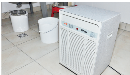
Photo 6 – Un déshumidificateur d'air permet de maintenir l'humidité de l'air à un bas niveau dans la miellerie. (Photo : Ruedi Ritter)
