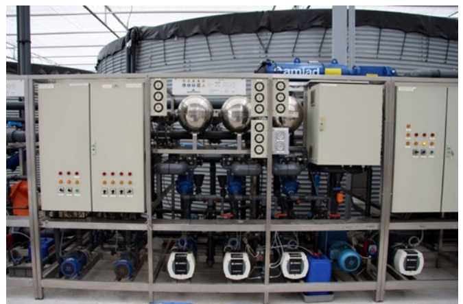
Abbildung 7: System zur Desinfektion des Wassers mit UV-Strahlung. (Foto: V. Günther)
