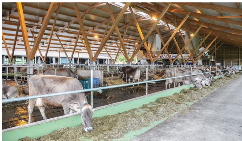
Ein offener First ermöglicht ungehinderten Luftaustausch und bringt Licht in den Stall. Idealerweise sollte die Firstöffnung über dem Laufgang platziert sein.
