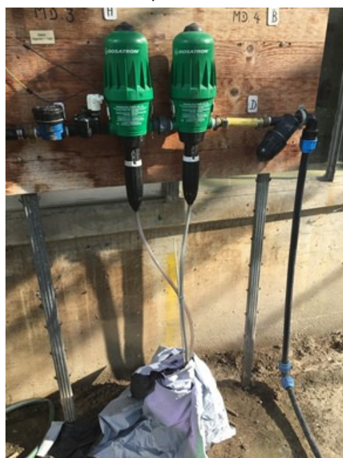
Fig. 2. Installation d'irrigation: pompes doseuses, filtre et compteur.
