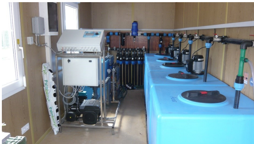
Figura 5. Installazione automatizzata per la preparazione della soluzione nutritiva destinata a piccoli frutti coltivati su substrato.
